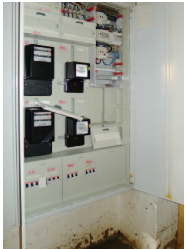
Überfluteter Sicherungskasten in einer Erdgeschosswohnung
