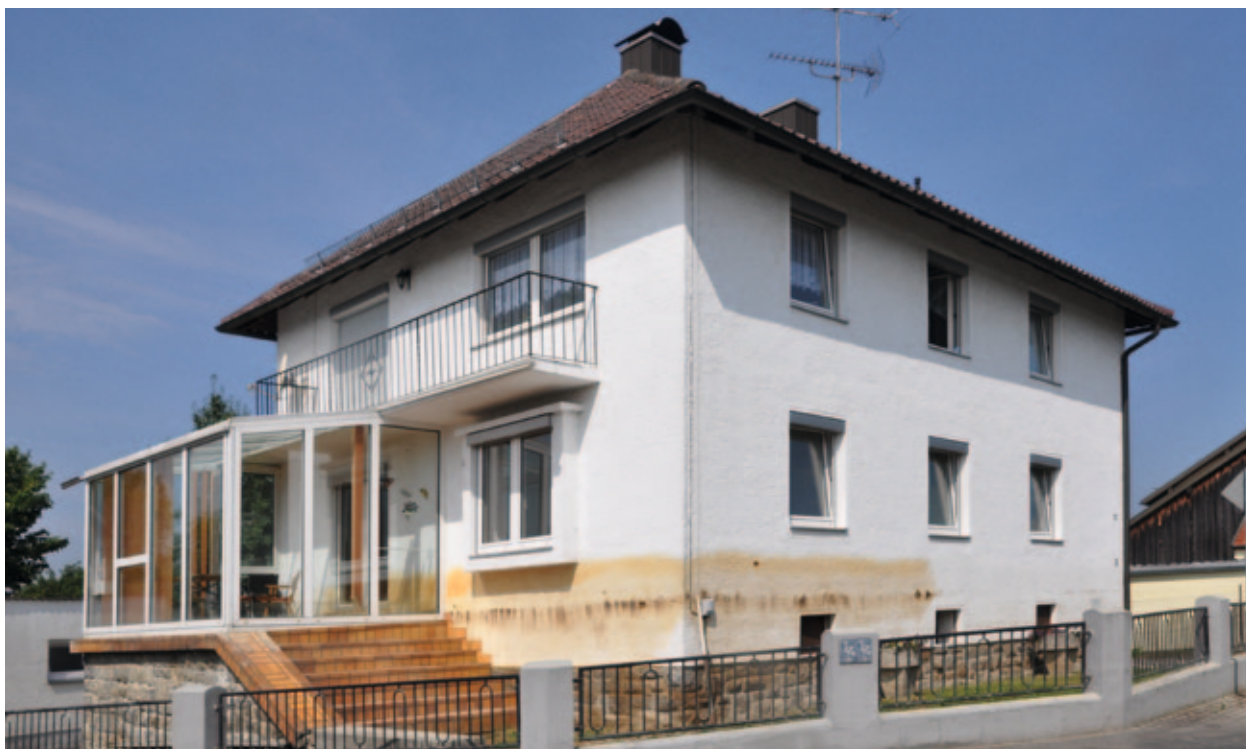
Mit Heizöl belastetes Wärmedämm-Verbundsystem eines Wohnhauses
