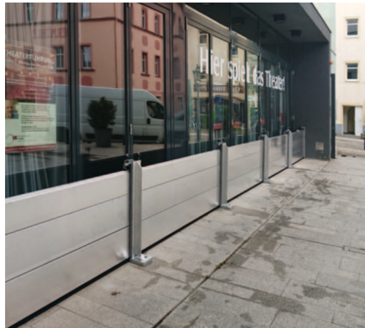
Objektschutz mit teilmobilen Schutzelementen
