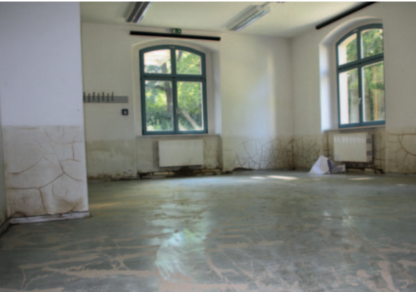
Durchfeuchtete und verschmutzte Außenwände nach Überflutung
