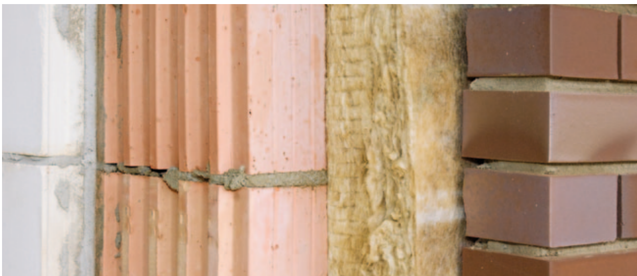
Bei mehrschaligen Außenwandkonstruktionen ist die durchfeuchtete Dämmstoffsicht nur sehr schwer zugänglich.
