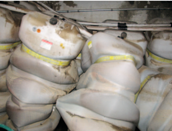
Zerstörte Heizöltanks infolge einer Hochwassereinwirkung
