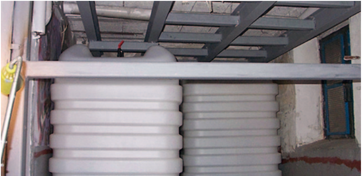
Heizöltankanlage mit Auftriebssicherung
